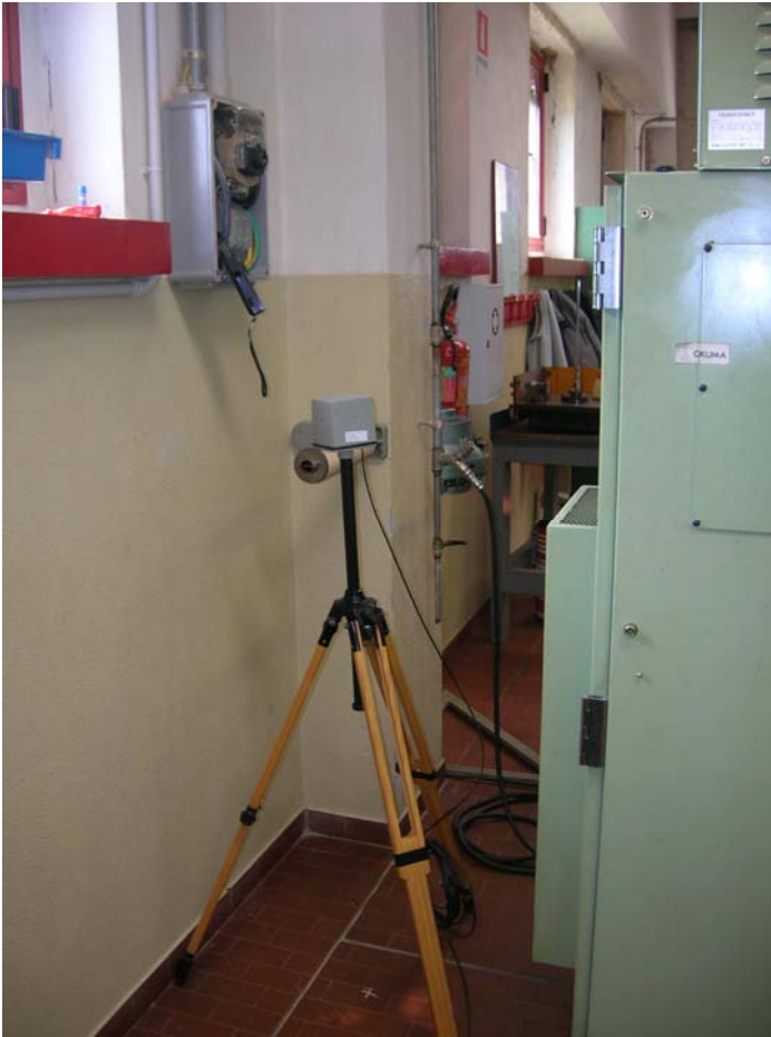
Misure di campo elettrico in prossimità del quadro di alimentazione e della zona trasformatori della macchina
